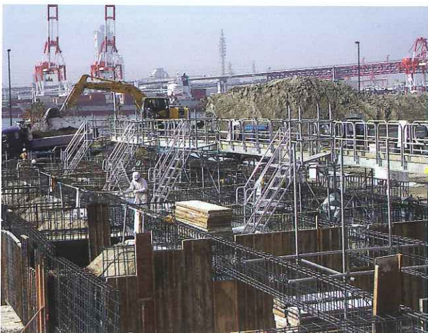
安全通路よりピットへの昇降設備
