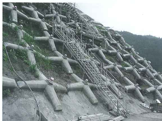
作業員の昇降用通路
