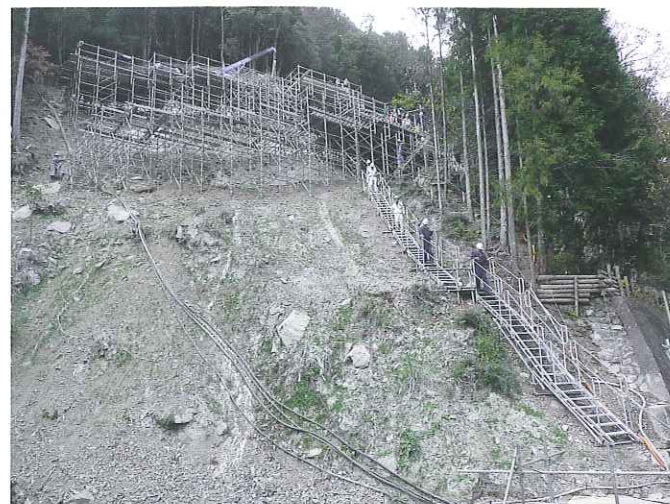
作業員の昇降用通路
