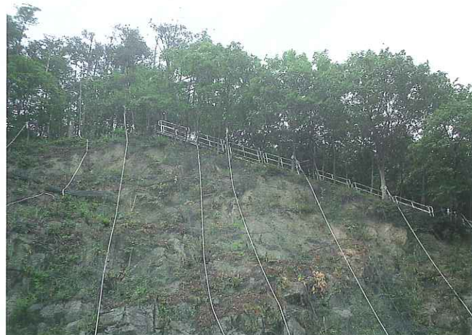
親綱点検用としての昇降設備
